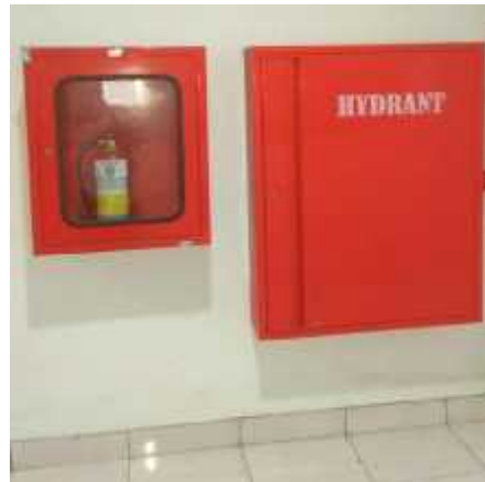
Gambar 2. Alat APAR dipasang di luar ruangan yakni di dinding lorong gedung.
